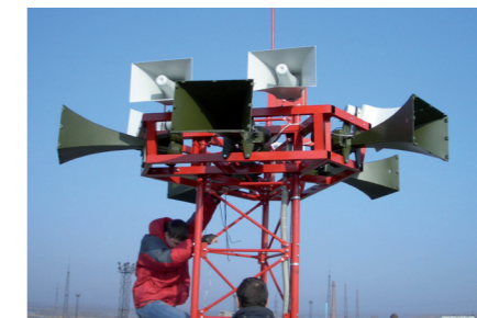
Система оповещения на объекте
